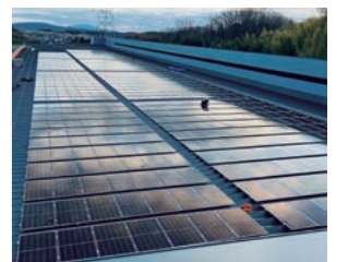
生駒事業所の太陽光発電設備
