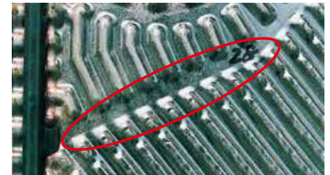
↑ プレート当たり点・接触部近傍の隙間部にエロージョン・コロージョン発生
