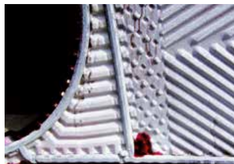
↑ 目視で確認された伝面部の貫通割れ(上) 浸透探傷試験で発見された貫通割れ(下)
