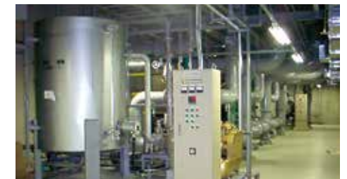
↑ D 社 I 発電所
