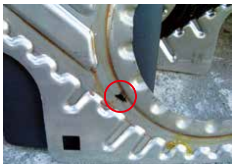
↑ ガスケット交換を行わないまま放置された熱交換器(上)、ガスケットラインで発生した隙間腐食(下)
